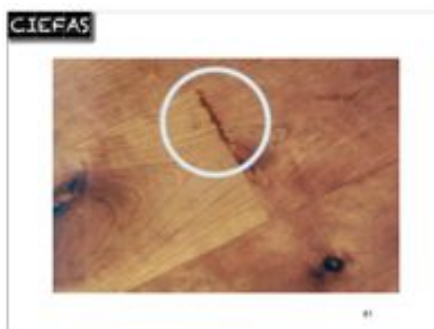
effets d'un dégât des eaux
