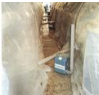
stop-corrosion par air sec
